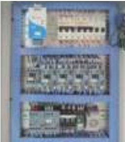
Caja eléctrica · Fuente de alimentación de 24 V. · Todos los contactores y relés SIEMENS o Schneider.
